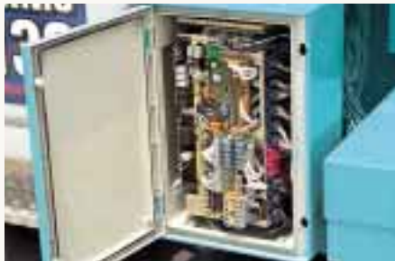
防水ボックスに収納されたI/O基盤
